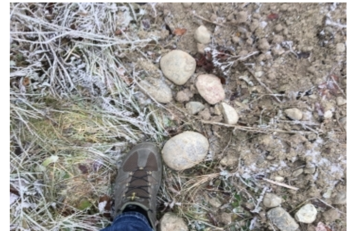
Bristfällig återställning av mark efter grävning. Här ska vara gräsyta.
