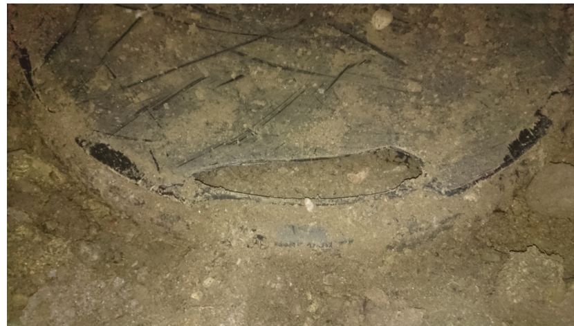
Trasigt brunnsluck troligen förstört i samband med frisättning av brunnen
