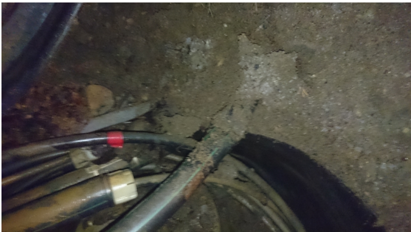
Skadad kanalisation beroende på Att den lagts ovanpå brunnen och inte dragits in i brunne från sidan.
